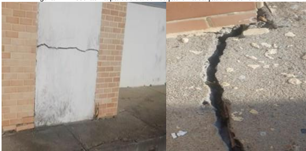
Figura 7 – Fissuras na parede da edificação e na calçada de concreto.
