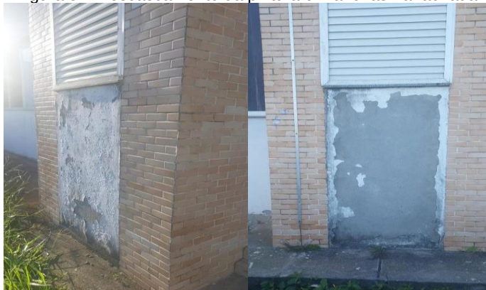
Figura 5 – Descascamento da pintura e manchas na fachada.
