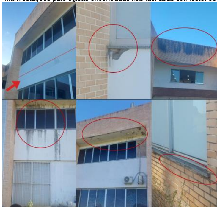
Figura 9 – Manifestações patológicas encontradas nas fachadas sul, leste, oeste e norte.
