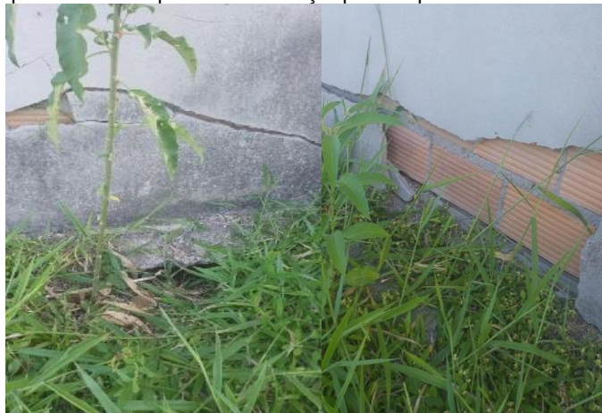
Figura 8 – Deslocamento de partes do emboço que compõe o revestimento de argamassa.
