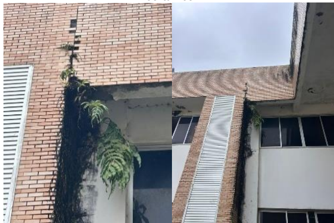
Figura 6 – Biodeterioração física, manchas escuras no revestimento de argamassa e no revestimento cerâmico.
