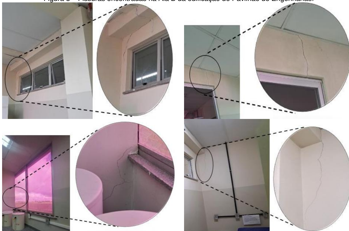
Figura 3 – Fissuras encontradas na Ala B da edificação do Pavilhão de Engenharias.
