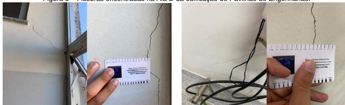
Figura 5 – Fissuras encontradas na Ala D da edificação do Pavilhão de Engenharias.
