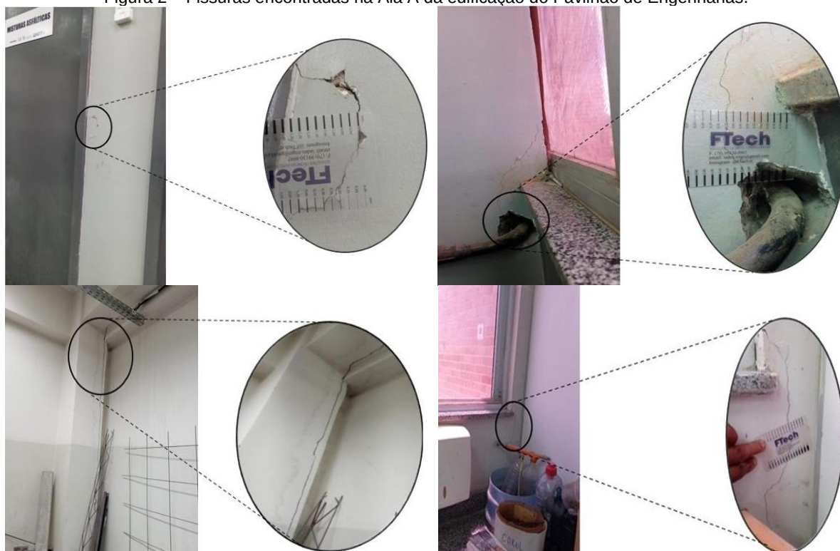
Figura 2 – Fissuras encontradas na Ala A da edificação do Pavilhão de Engenharias.
