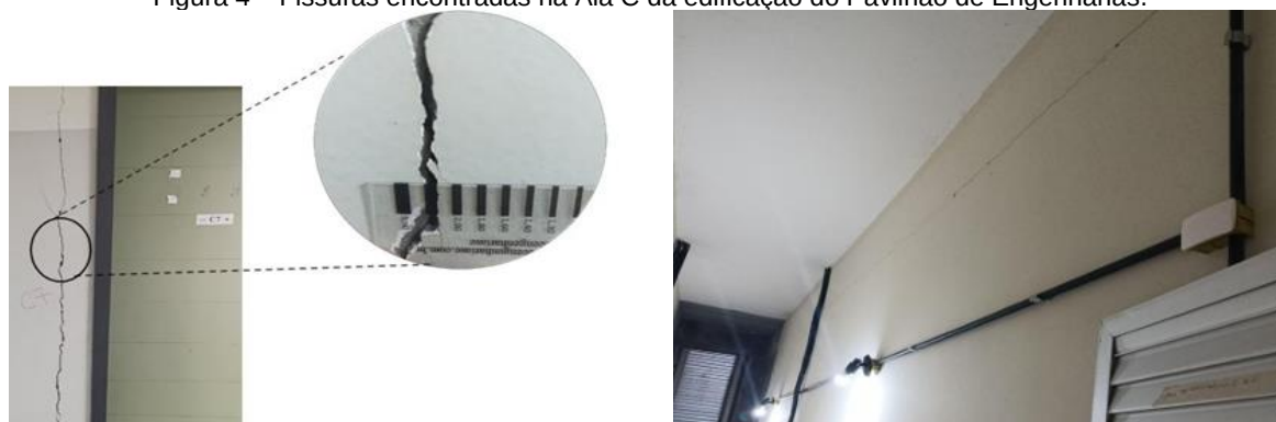
Figura 4 – Fissuras encontradas na Ala C da edificação do Pavilhão de Engenharias.
