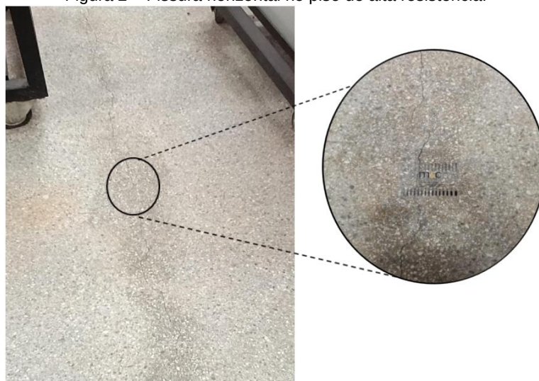
Figura 2 – Fissura horizontal no piso de alta resistência.
