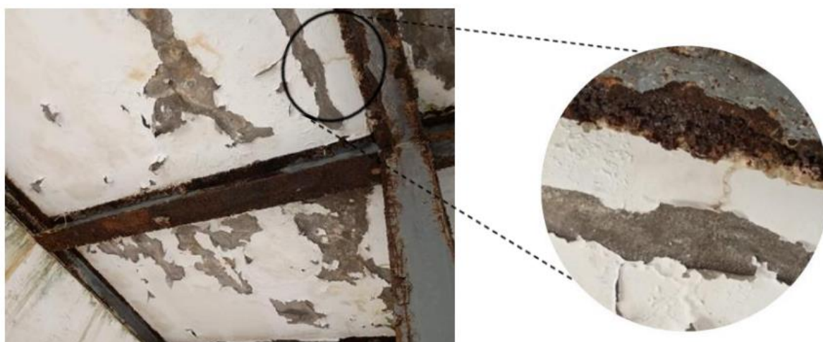
Figura 5 – Fissuras e manchas na laje de cobertura da rampa.
