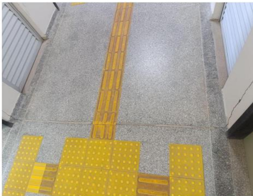
Figura 4 – Fissura na interface parede e pilar sala C7.
