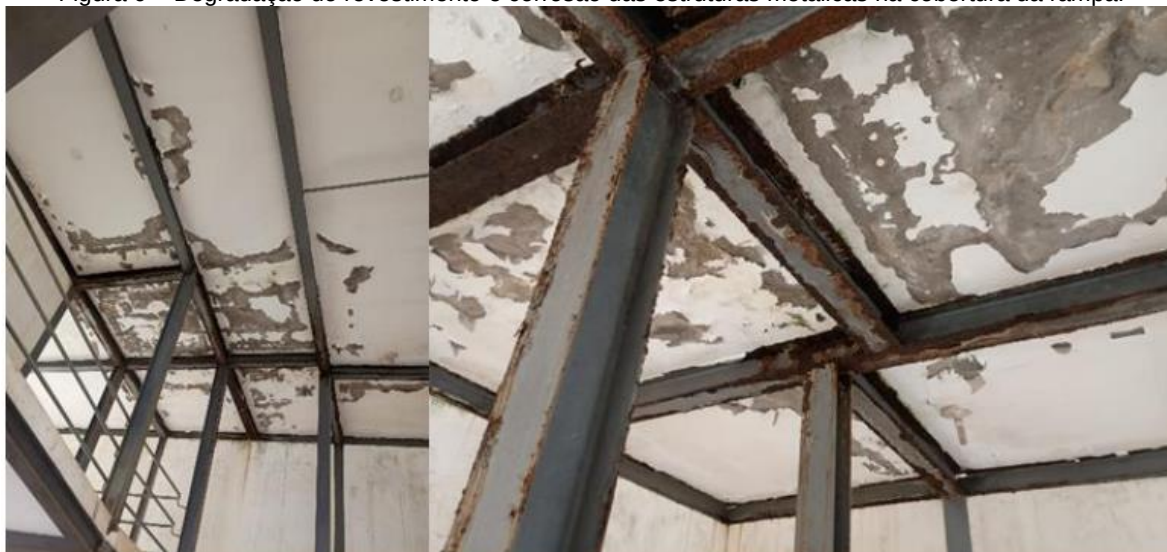
Figura 6 – Degradação do revestimento e corrosão das estruturas metálicas na cobertura da rampa.
