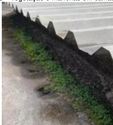
Figura 3 – vegetação e manchas em calhas e vãos.
