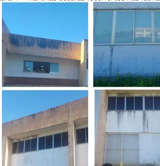
Figura 4 – Manchas escuras recorrentes nas fachadas.
