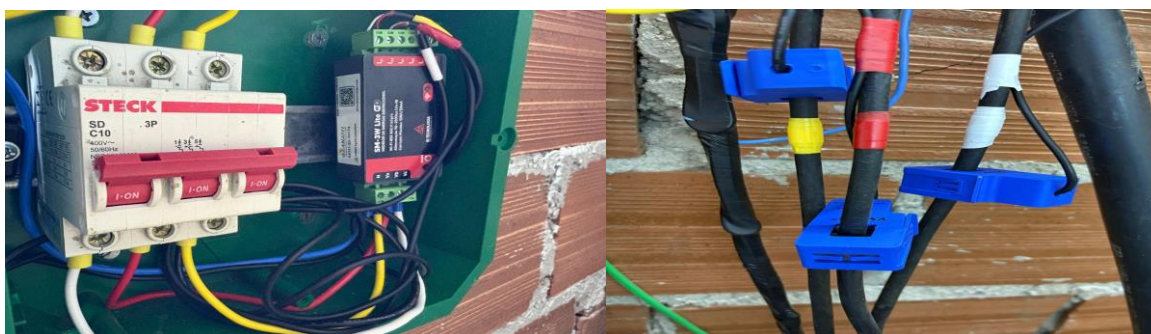
Figura 1 – Transformador de corrente e medidor de energia
