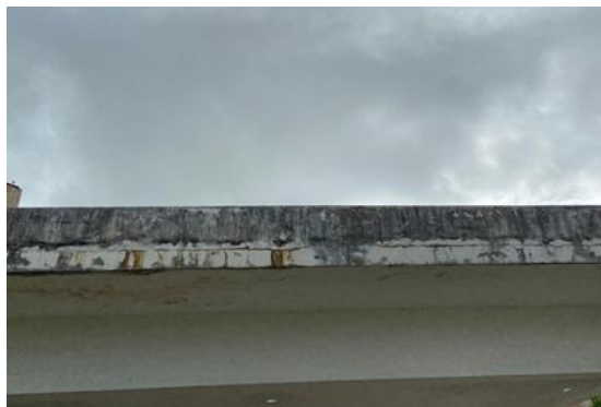
Figura 6- Fissuras na interface alvenaria-laje nos prédios estudados.
