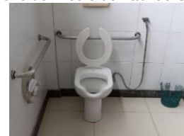
Figura 15 - Suporte de papel higiênico sem tampa e lixeira quebrada em banheiro do Prédio de Lab. do CCAAB.
