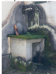
Figura 5 - Cobrimento de material orgânico sob tampo de concreto.
