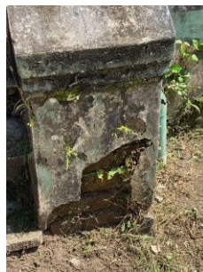
Figura 3 - Desplacamento do revestimento argamassado.
