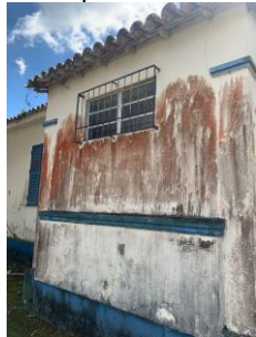
Figura 7 - Presença de microrganismos nas paredes.
