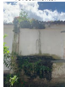
Figura 4 - Desenvolvimento de plantas no telhado e escurecimento de regiões do revestimento.
