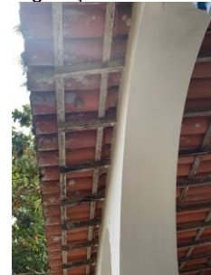
Figura 8 - Presença de microrganismos e vegetação no telhado.
