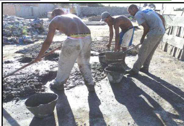
Figura 2 - Operários sem uso de EPI's de segurança e expostos ao sol. (EP-A)
