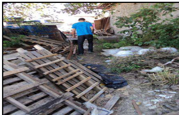
Figura 7 - Área destinada os trânsito de pessoas e materiais, bloqueada com entulho e impedindo a movimentação com segurança. (EC-C).
