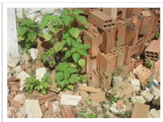
Figura 3 - Perda de blocos cerâmicos.
