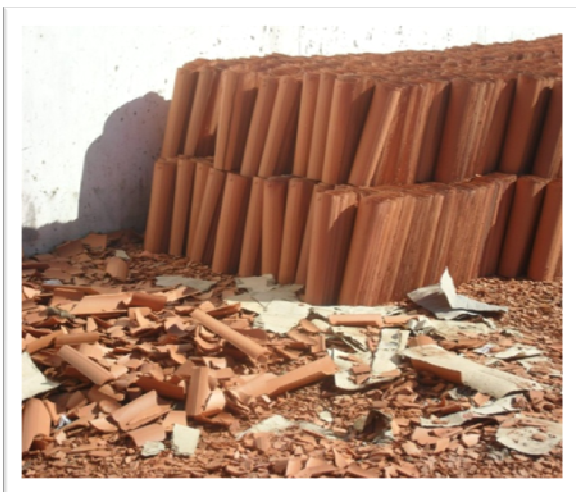
Figura 9 - Perda de telhas cerâmicas.
