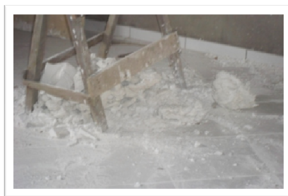
Figura 6 - Perda de gesso.
