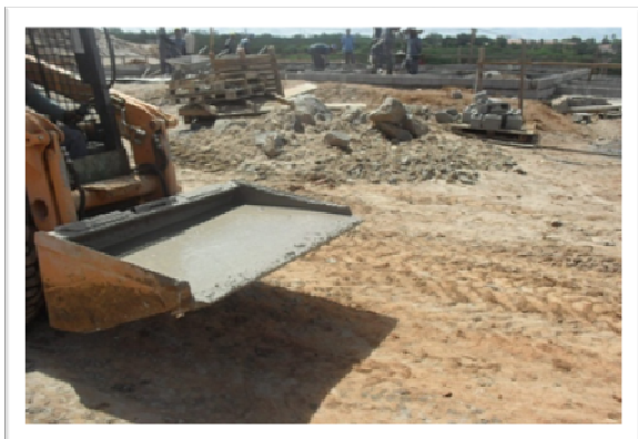
Figura 1 - Perda de concreto.
