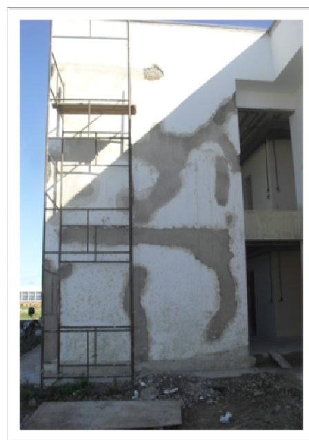
Figura 7 - Atividades de retrabalho devido a patologias na edificação.
