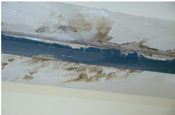
Figura 15 - Detalhe do manchamento na reitoria
