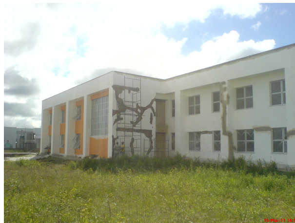
Figura 10 – Unidade do Centro de Ciências Agrárias e Biológicas sofrendo reparos na fachada
