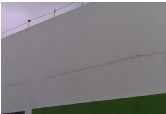
Figura 8- Fissura horizontal no pavilhão de aulas 2
