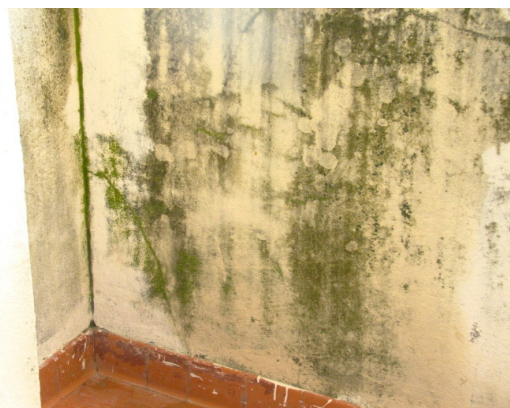
Figura 2 – Mancha de bolor no prédio da reitoria
