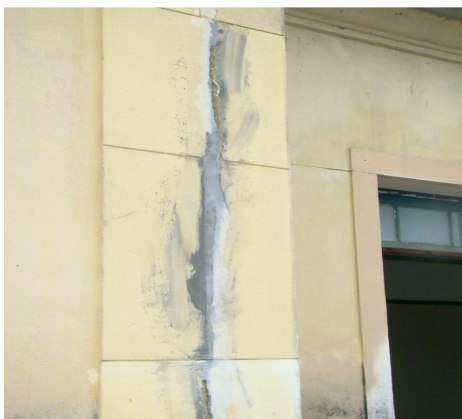
Figura 4 – Fissura vertical no prédio da reitoria
