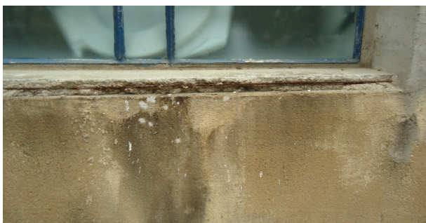
Figura 12- Pavilhão de Química apresentando manchas
