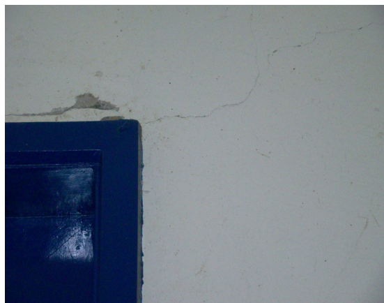
Figura 7- Fissura no prédio da reitoria
