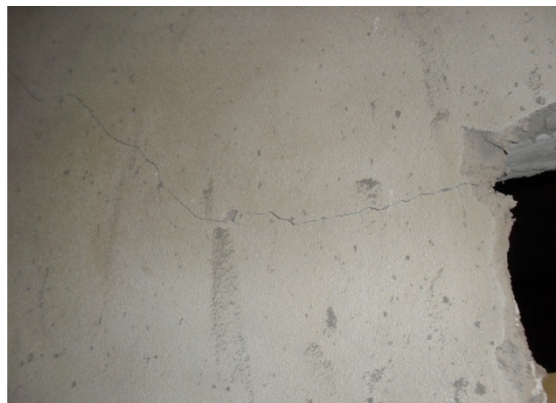
Figura 6 – Fissura em uma parede inacabada do Hospital de Medicina Veterinária em construção
