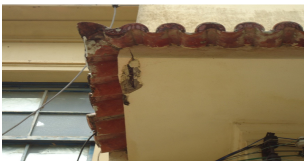
Figura 16 – Patologia no prédio de química
