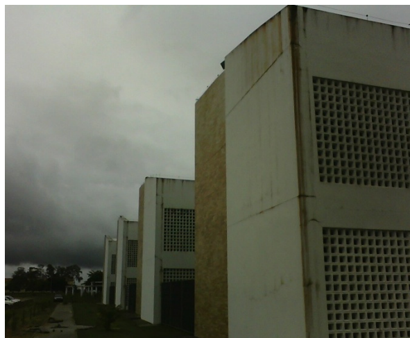
Figura 14 – Pavilhão de aulas 1 apresentando manchas na fachada
