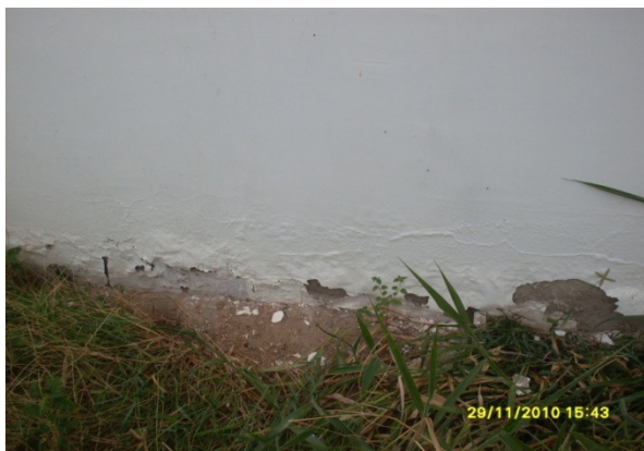
Figura 1 – Descascamento da tinta aplicada no prédio do Centro de Ciências Exatas e Tecnológicas
