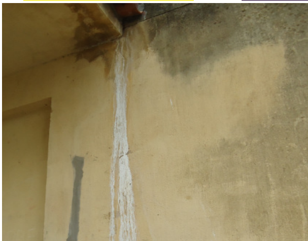
Figura 11- Manchas na fachada do pavilhão de química
