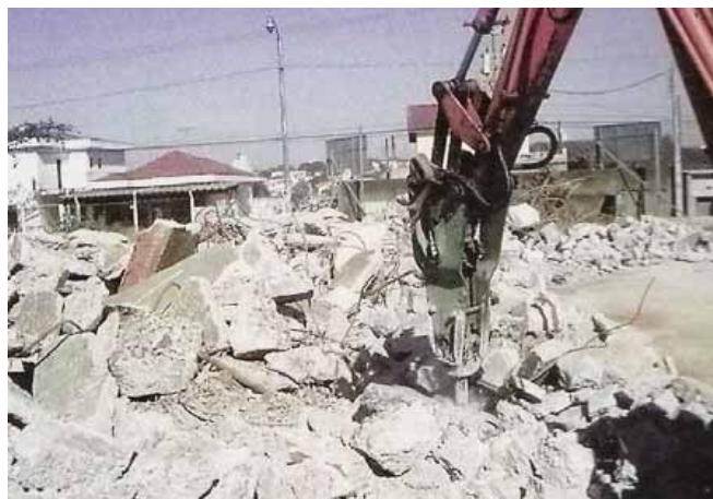
Figura 5 - Demolição do piso existente no terreno da Obra do condomínio Villaggio Maia (CAPELLO, 2006).
