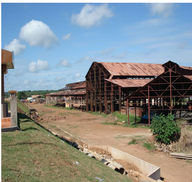
Figura nº 05 galpão da oficina, Porto Velho (RO) 06/06/2010.
