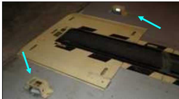
Figura 8: Fotografia mostra detalhe da fotocélula utilizada no novo sistema de esteira.
