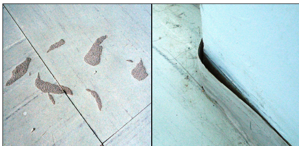
Figura 3 – Patologias do piso da UBS \gamma
