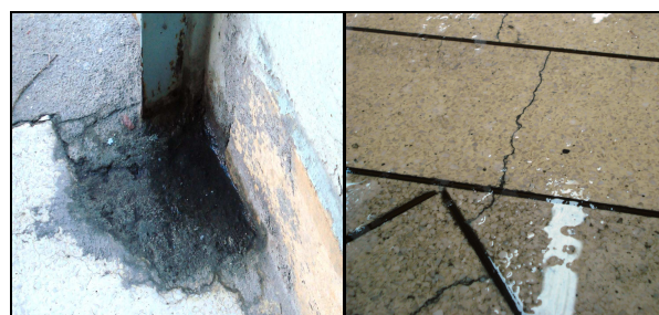
Figura 1 – Patologias do piso da UBS \alpha
