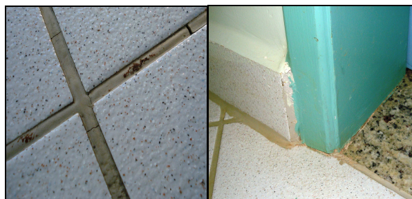
Figura 2 – Patologias do piso da UBS \beta
