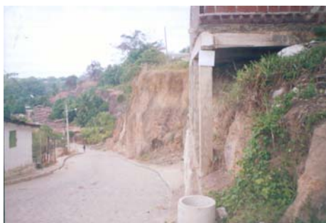
Figura 4- Encosta desprovida de obras de contenção.
