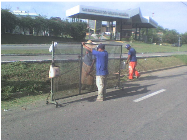
Figura 1: Como podemos nesta foto tirada em frente à Universidade do Vale do Paraíba, Campus Urbanova, o operador da tela de proteção fica ao nível da via, para a proteção de objeto lançados, mas não se protege dos veículos, além de ser uma mão de obra que poderia ser utilizada de forma mais eficaz.
